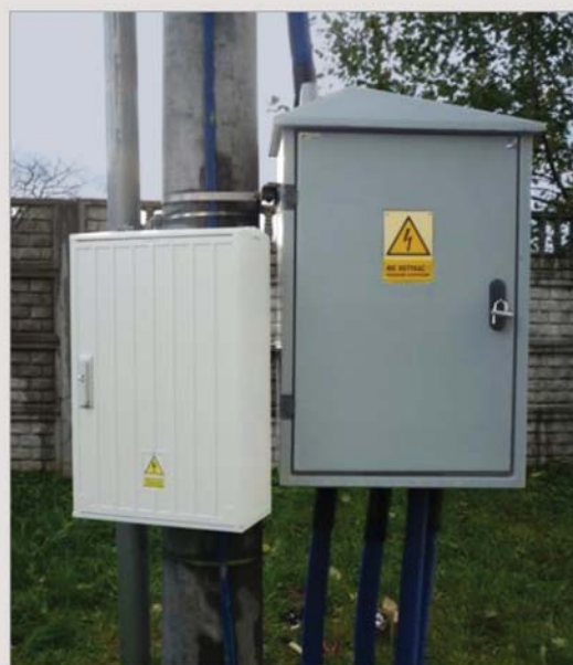
Rysunek 22. Szafa pomiarowa bilansująca zamontowana na stacji napowietrznej
