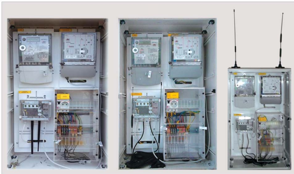
Rysunek 20. Widok szafy wraz z urządzeniami: z pilotażu 3GPP/CDMA oraz z uwzględnieniem wniosków z pilotażu 3GPP/CDMA poprzez zastosowanie anteny z kablem 3m i podstawką magnetyczną
