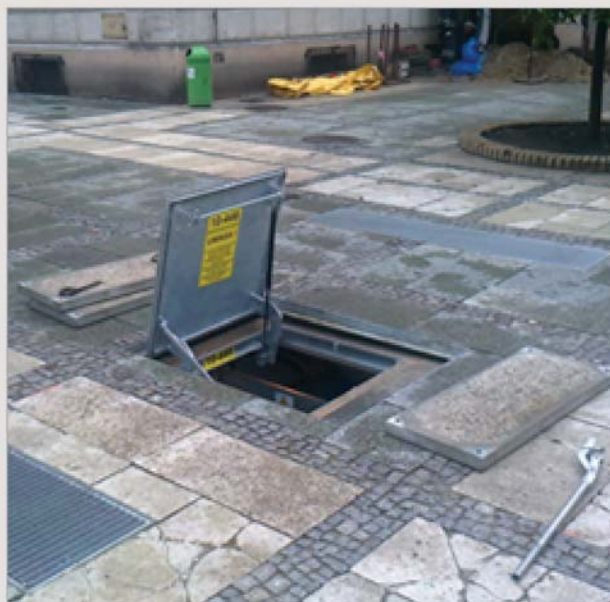
Rysunek 21. Podziemna stacja transformatorowa na rynku w Kaliszu
